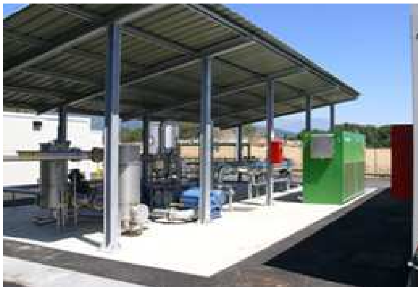
L'impianto a biogas di Grosso
